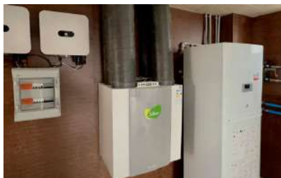
Sistema de Ventilación de la vivienda
