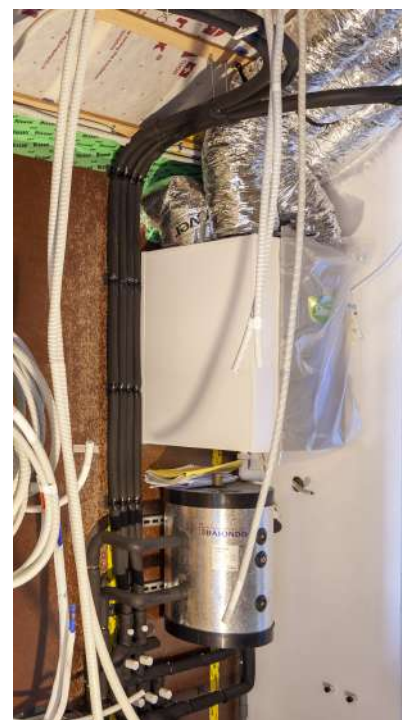
Sistema de Ventilación de la vivienda
